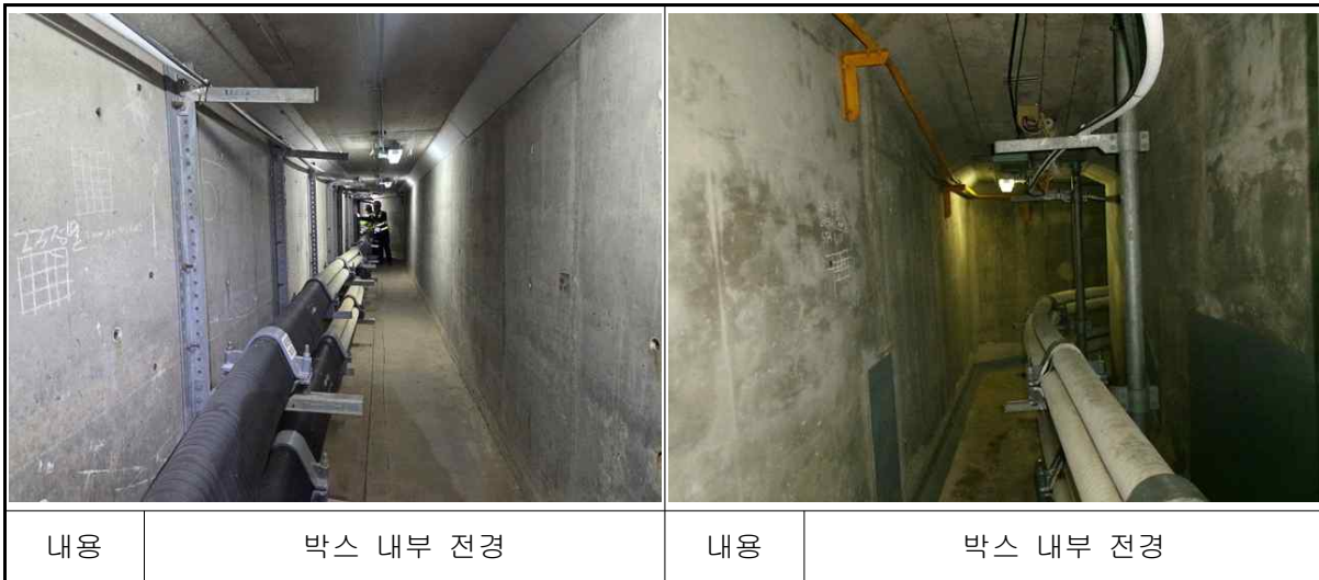
【사진 4.1】 송포일산인출 전력구 현황
